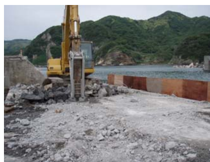
(コンクリート破片落下防止柵)
