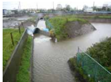
大雨による調整池の機能状況
