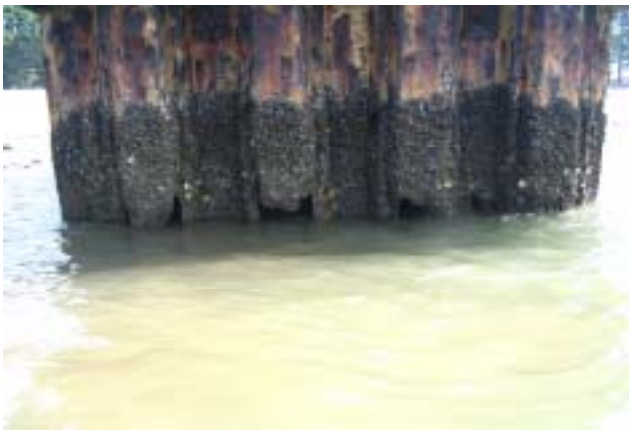
写真-1 矢板腐食状況
