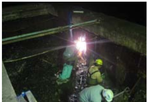
写真-2 矢板腐食部溶接状況
