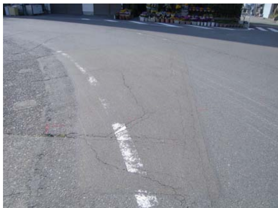
写真③ 既設舗装(クラック)
