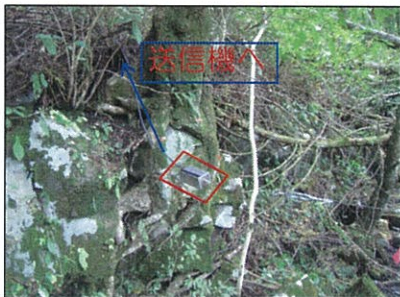
土石流センサー設置状況
