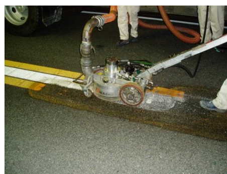
写真2 白線抹消状況近景
