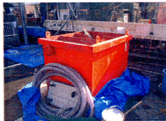
洗い水貯留水槽タンク
