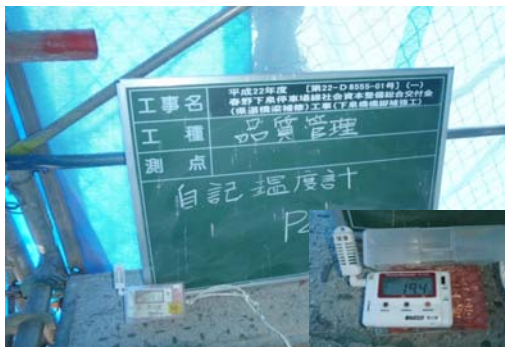
自己記録温度計の設置
