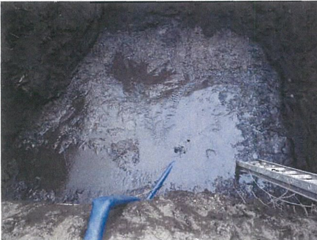
試験掘りによる支持層の湧水状況
