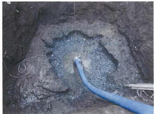
試験掘りによる支持層の湧水状況
