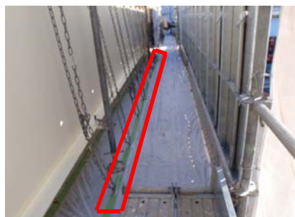
設置箇所写真
