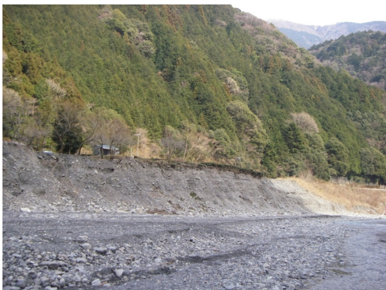
写真-1 被災状況
