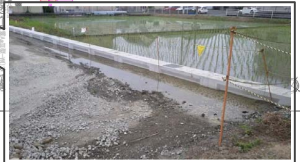
隣接する水田の水が路床部分に浸透している。
