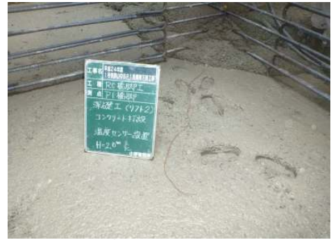
温度センサー設置状況
