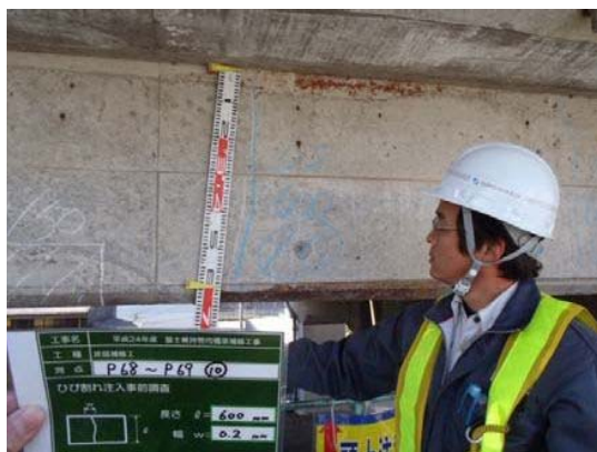
ひび割れ調査写真
