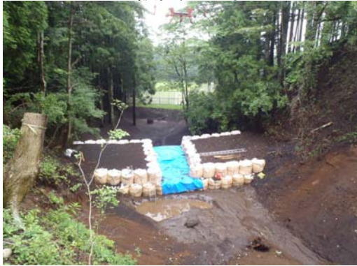
通常の降雨では機能していた(奥がゴルフ場)
