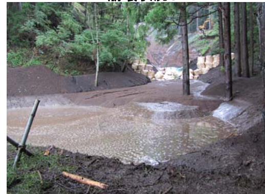
水路へ土砂流入(手前ゴルフ場)
