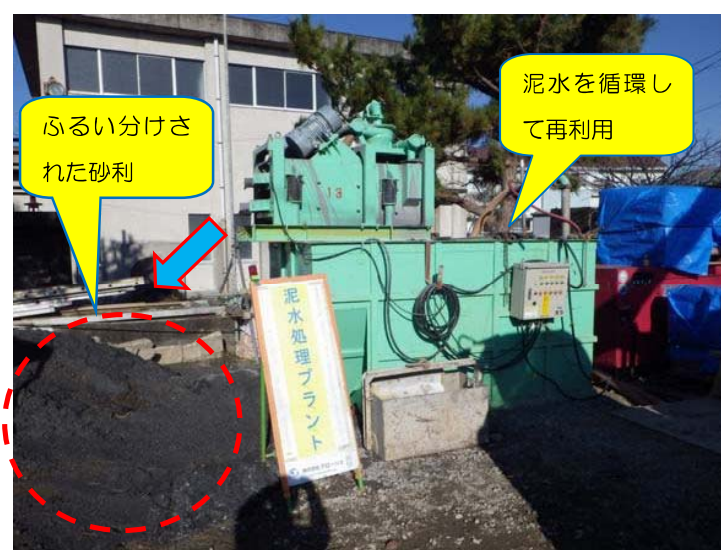
泥水処理プラント
