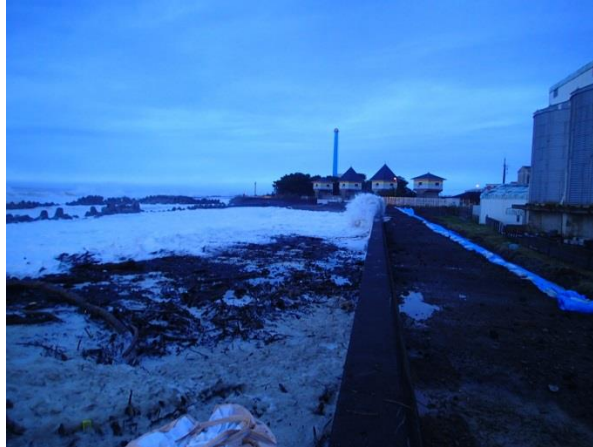
施工箇所越波状況
