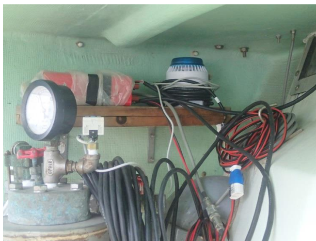
センサー設置状況
