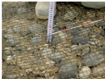
写真(4)：空隙確認 接写
