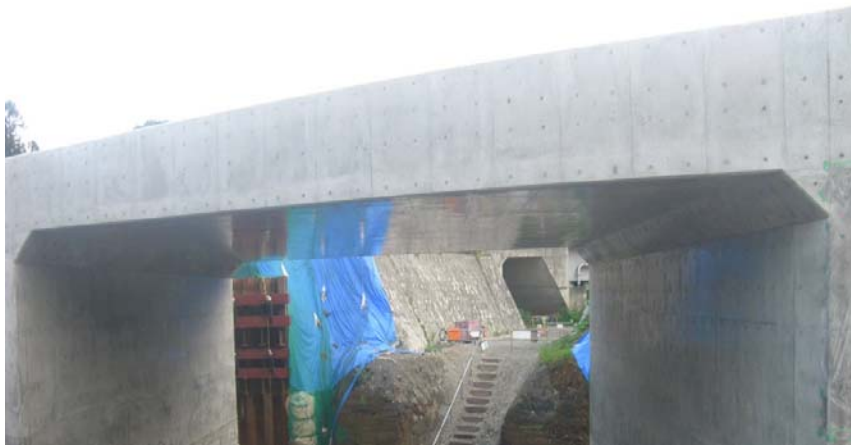
はく落対策実施部分全景
