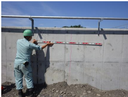
(沈殿槽付近⑦) 誘発目地より 1.0m
