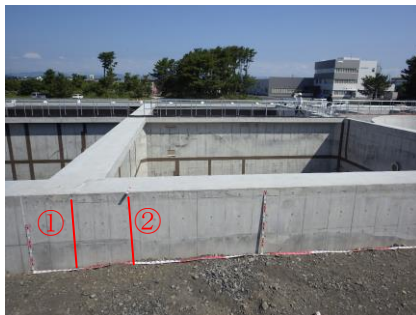
(曝気槽 3 付近) クラック 2 箇所発生
