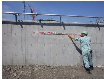
(汚泥貯留槽付近⑧⑨) 誘発目地より 1.0m、2.3m
