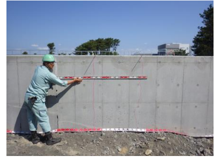
(沈殿槽付近-2) 誘発目地より 0.8m、1.9m
