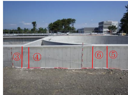
(沈殿槽付近) クラック 4 箇所発生
