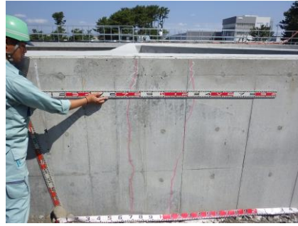
(沈殿槽付近-1) 誘発目地より 0.7m、1.2m
