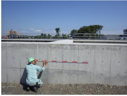
(曝気槽 3 付近) 誘発目地より 0.5m、2.0m
