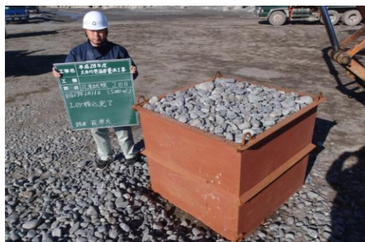
比重確認試験・計量機 1.0×1.0×1.0
