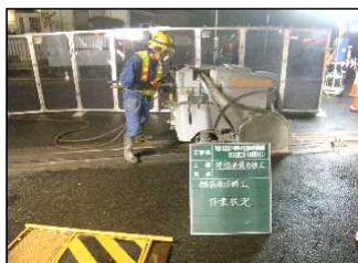
【防音フェンス】
