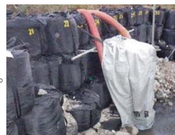
水中ポンプ 防音対策
