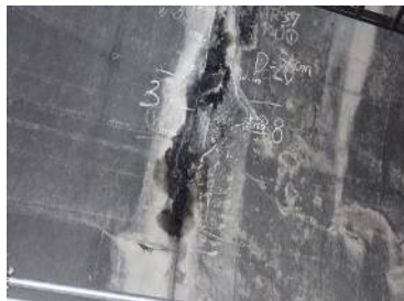
崩落崩壊箇所:対策前
