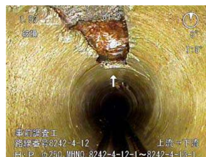
管渠内破損状況
