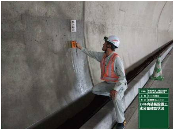
結露発生あり
