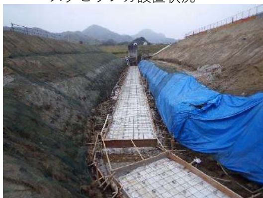
スタビランカ設置状況
