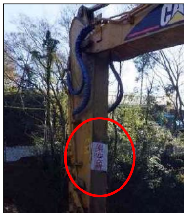
重機オペレーターへの注意喚起
