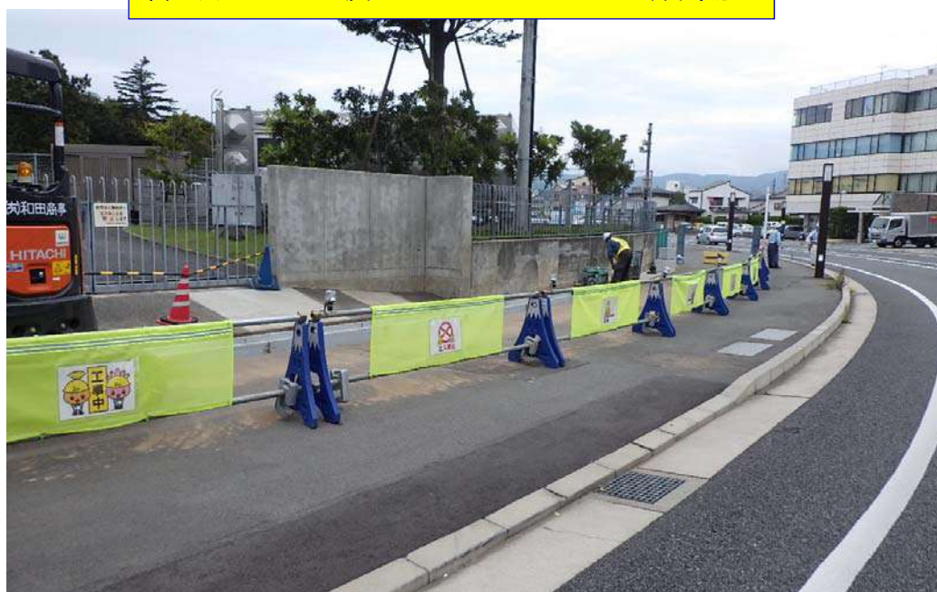
富士山バリケード及びサインシェイドによる明示状況
