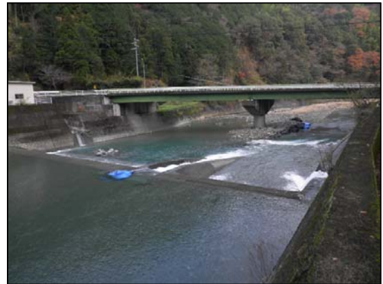
増水による流出(興津川上流)
