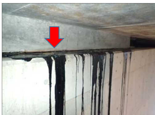
アイガスの発生 道路に垂れ落ちてしまっている
