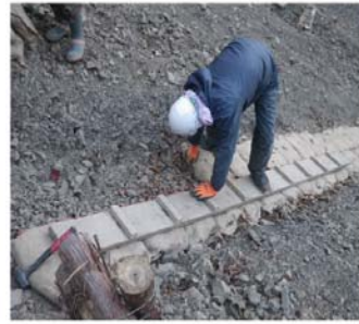
【設置状況(底面部)】
