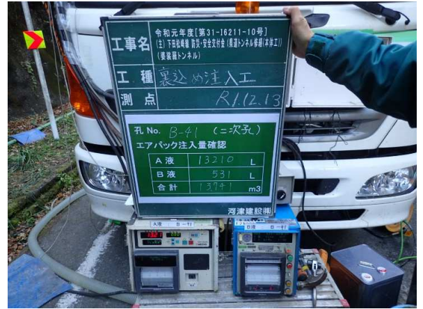
流量計管理状況(写真-4)
