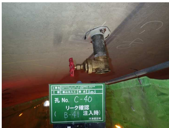
リーク確認状況(写真-5)
