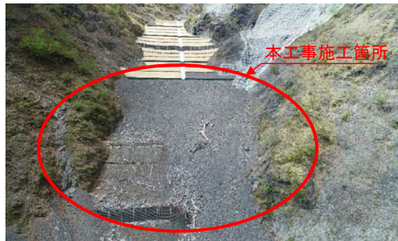
崩下より林道側を望む
