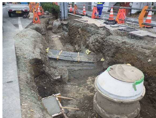
図 2-2 路床入替部 露出配管
