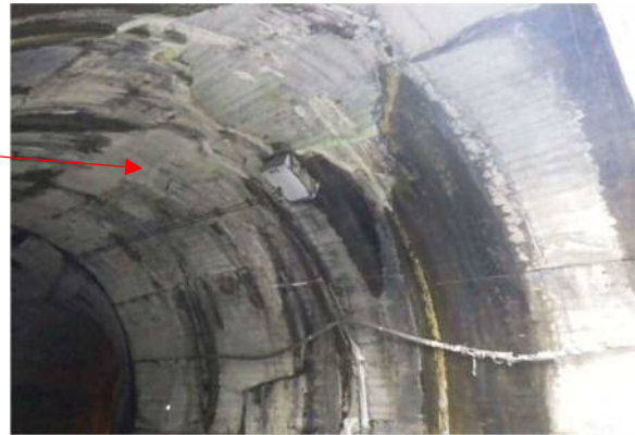
写真-2 漏水箇所
