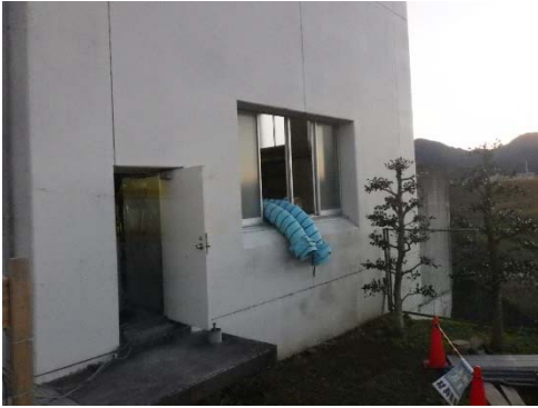
送風機による給排気（外側）
