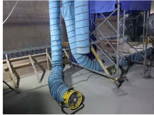
送風機による給排気（内側）
