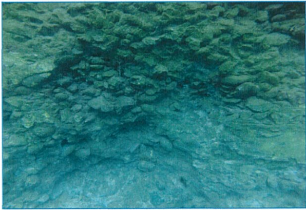
<写真1>劣化状況写真
