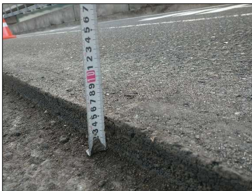
写真-3 基礎撤去後の段差
