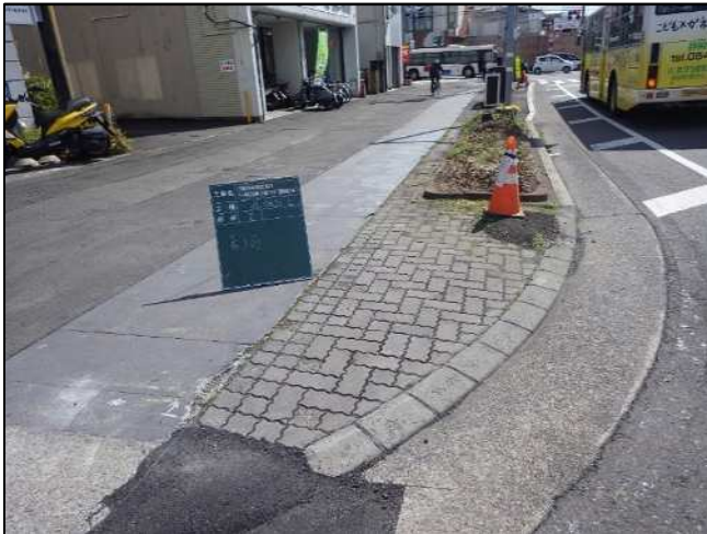
着手前の段差
