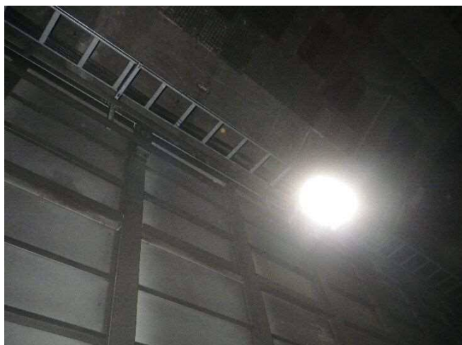
写真-1 天井への配線添架物状況
