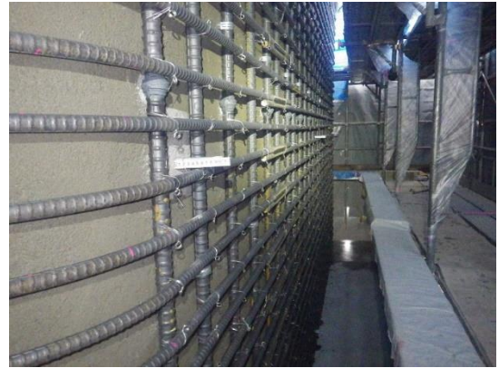
(左岸・右岸の上中段に各3箇所設置)
