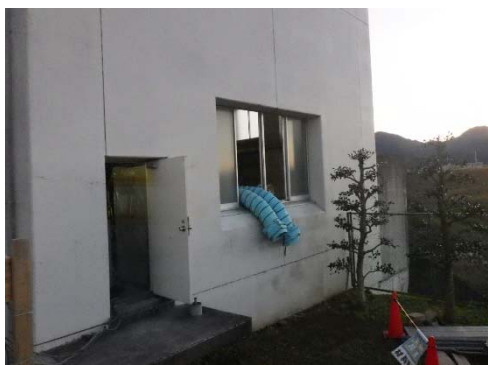
送風機による給排気（外側）
