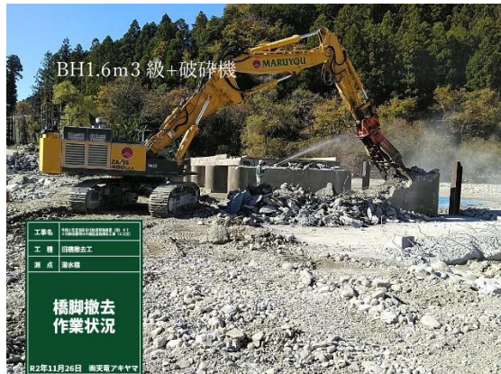
橋脚幅 1.5 m < 破碎機開口幅 2.0m
