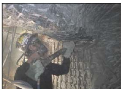
脆弱部研り状況
