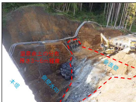
写真-5 温泉余土の分布 本堤より下流を望む
