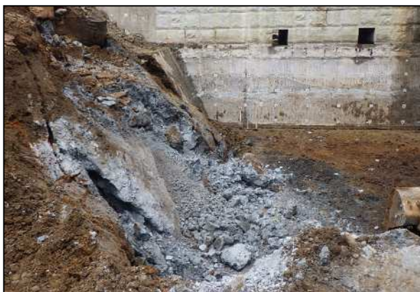
写真-3 本堤下流右岸側の地山一部崩壊 下流側から望む
