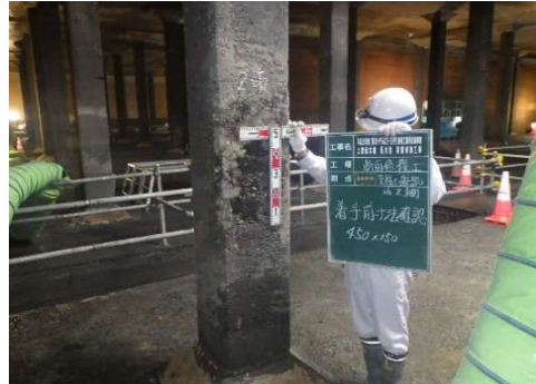
施工不良による豆板
