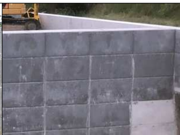
図-7 本工事のコンクリート打設後の残存型枠表面
