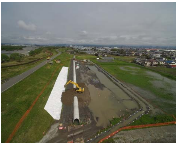
増水時に水路があふれた状況
